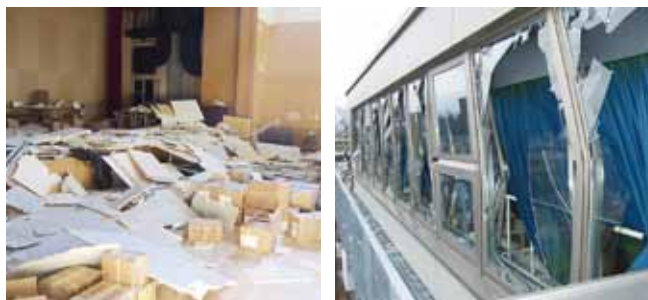
地震により被害を受けた50周年記念館(ハットN E)
